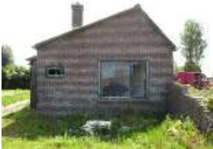
Noordwestgevel - rechts porrieplek
